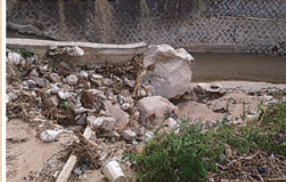
流れがひどくぶつかる箇所は護岸が崩れてしまっている
